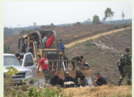
Bulldozer milik PT WKS menggusur lahan warga Desa Intan Jaya dan Bukit Indah – Tanjab Barat. Tanaman sawit (4-5 thn) dan tanaman lain milik warga dikubur perusahaan untuk menghilangkan alat bukti.
